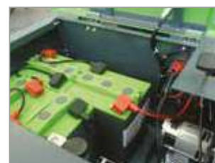
ALOJAMIENTO DE BATERÍAS (1250 E)
